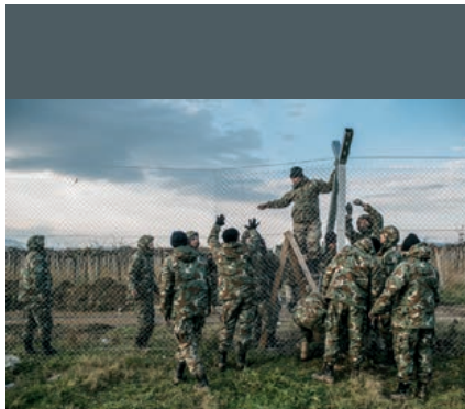
Die mazedonische Armee errichtet einen Grenzzaun in der Nähe von Idomeni/Griechenland © UNHCR / Daniel Etter
