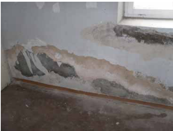
Schimmel an der Wand
