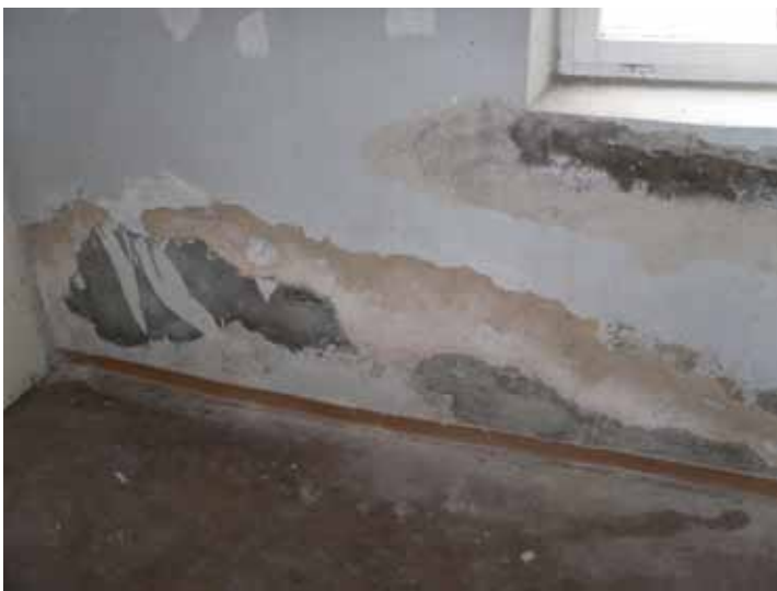
Schimmel an der Wand
